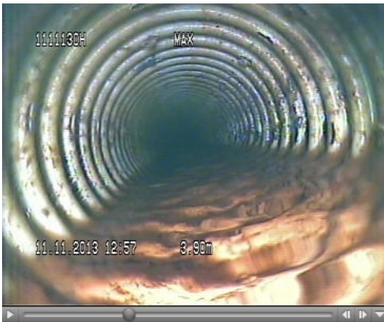
Figuur 5 Goede ontwatering door drain, geïnstalleerd in Texelse zeeklei (foto: L C P M Stuyt, 11 november 2013)
